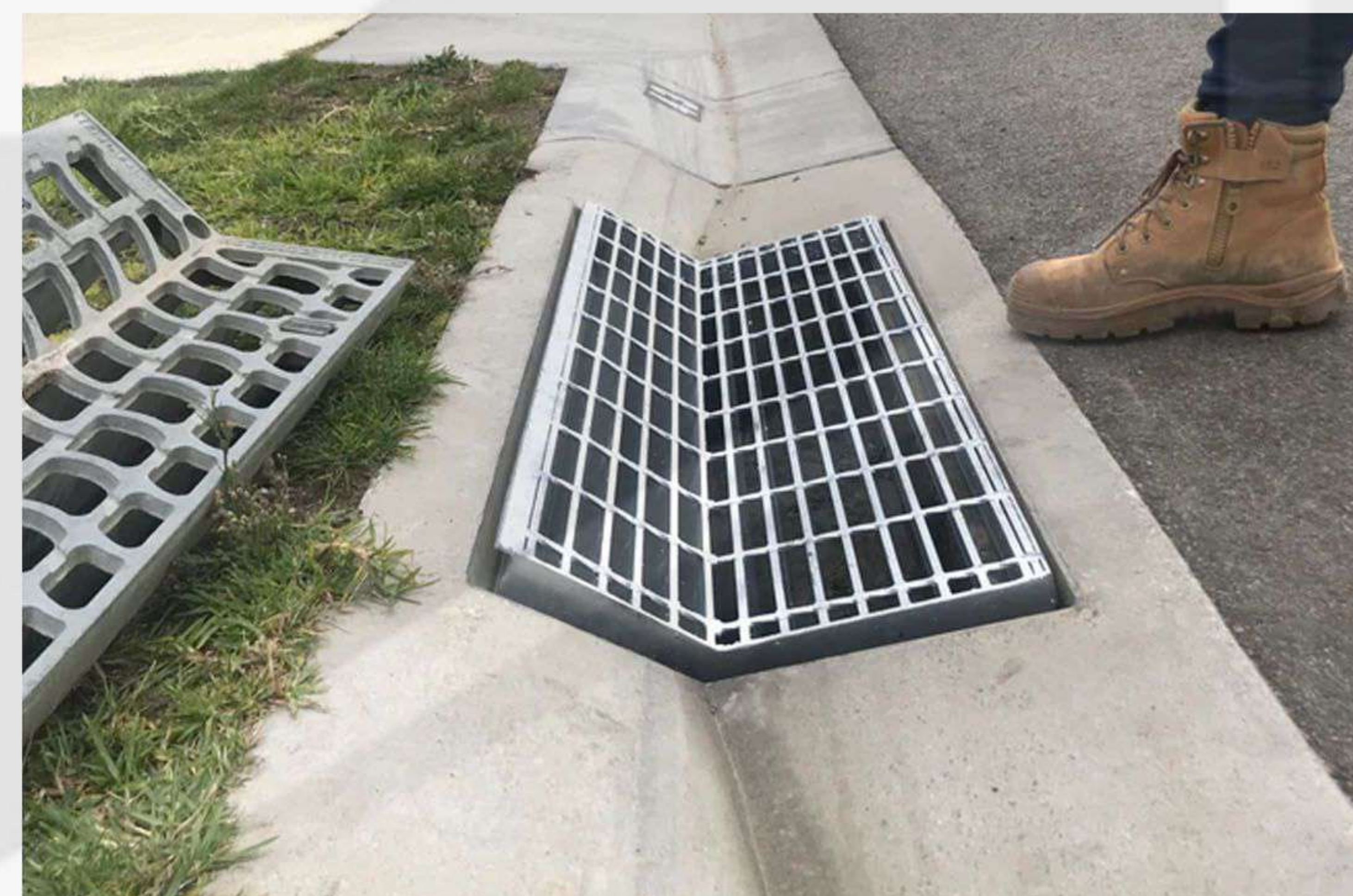
Bó vỉa thoát nước/Drainage curbs
